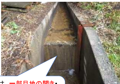
1号開渠(L=111.5m)蓋付U型水路
