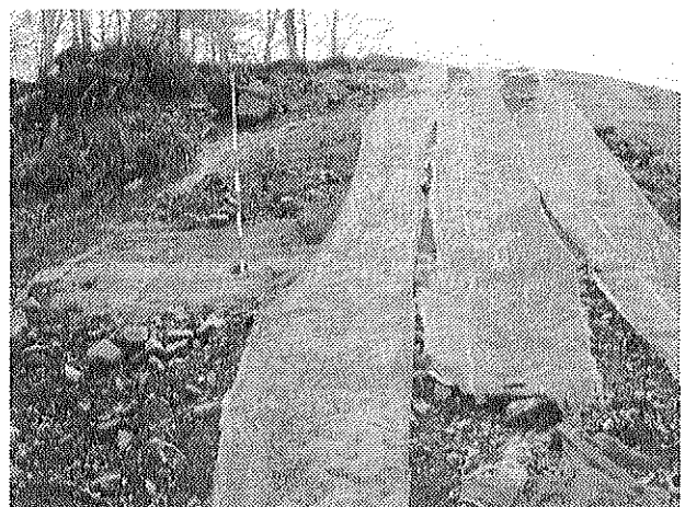
写真12 落下角礫岩による伏工損傷
