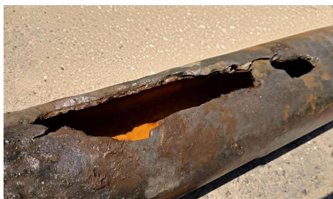
老朽化した铸铁管の状況
