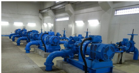
ポンプ設備 (及川ポンプ所)
