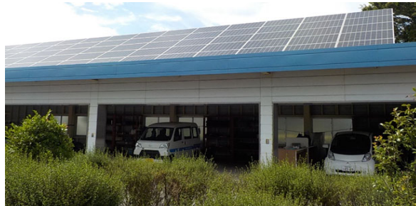
太陽光発電設備 (相模原水道営業所)
