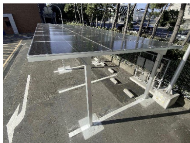
（県有施設に設置した太陽光発電）
