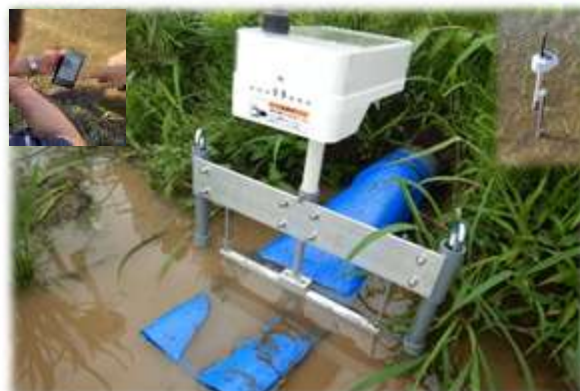
自動水門、水位センサー設置
