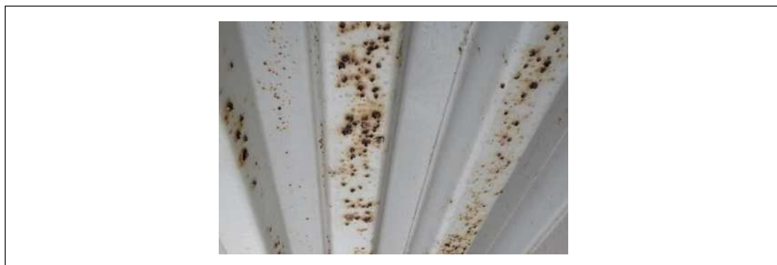
損傷の面積が大の例（着目部分の 50%以上に錆が生じている又は局所的な錆が着目部分内に多数発生して結果として着目部分の範囲内で拡がっている例）
