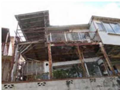
腐食したバルコニー
