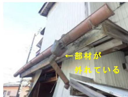
雨どいの垂れ下がり
