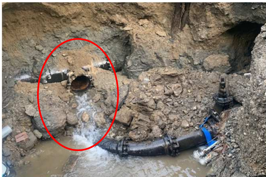
(図2 漏水箇所写真)
