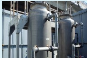
⑦ 地下水保全対策 有機塩素系化学物質で汚染された地下水を施設の装置に通すことにより水質浄化を図った。 (秦野市)
