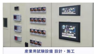
産業用試験設備 設計・施工
