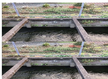
施工前(柵渠の劣化状況)
