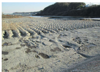
洪水による劣化状況（固定堰）
