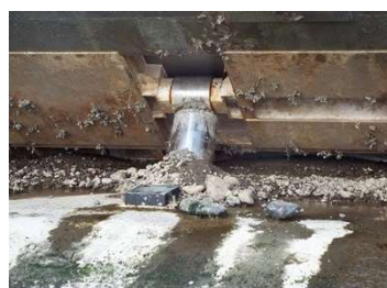
転倒ゲートの劣化状況
